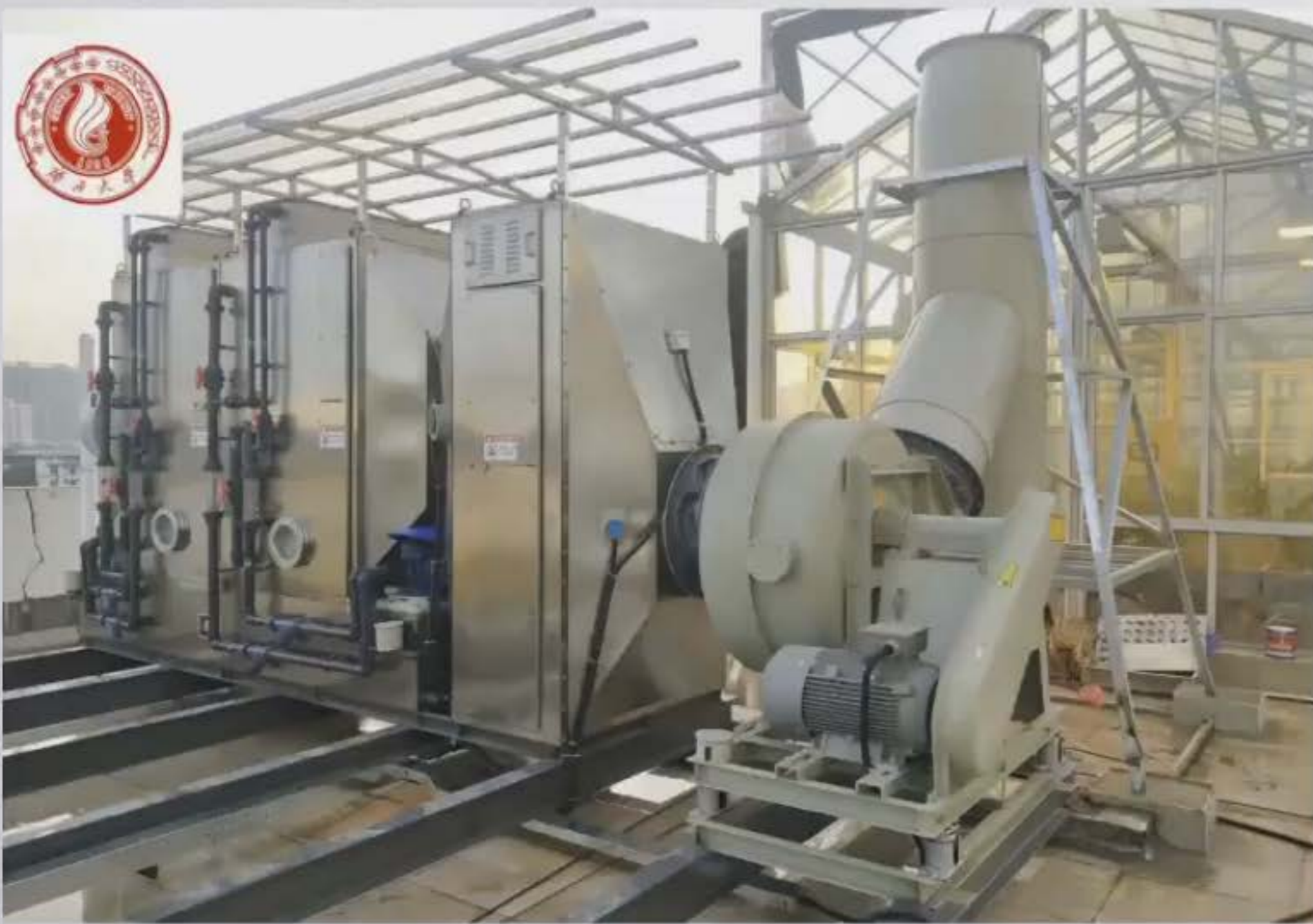
广西大学实验室混合废气排风控制系统及处理装置
